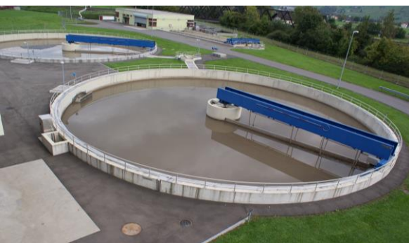
Abb. 4: Kläranlage ARA Schwyz (Foto ara-schwyz.ch)
