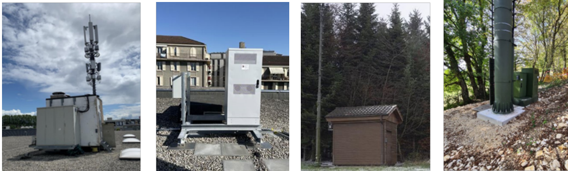
Abbildung 6: Typische Beispiele von Installationen von Mobilfunkanlagen in bebauten und ländlichen Gebieten.
