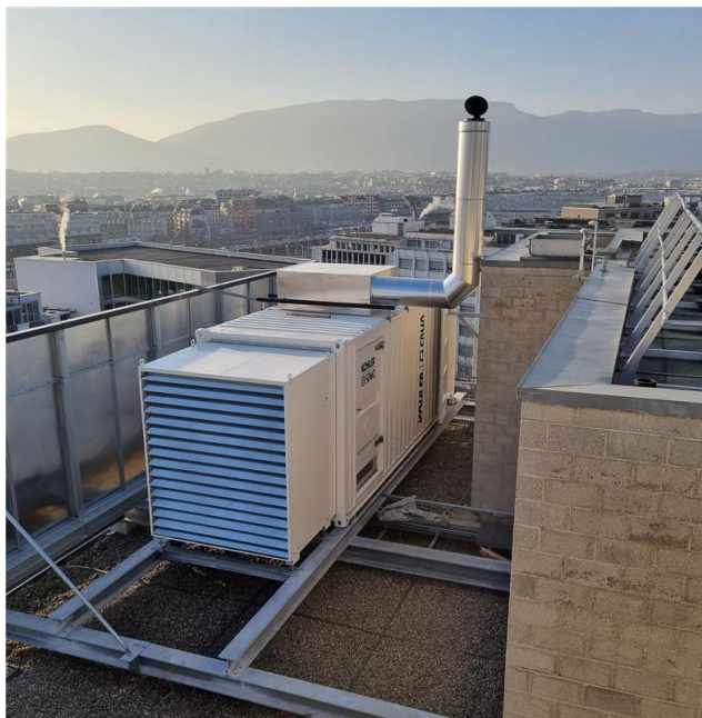
Abbildung 8: Typischer Aufbau auf Hausdach mit Dieselaggregat, Tank, Lüftung, Lärm- und Sichtschutzwand sowie Kamin.
