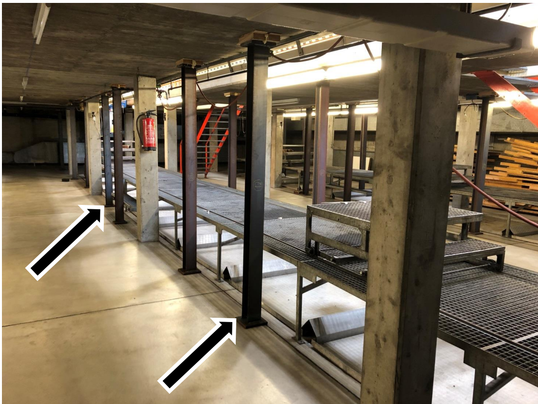
Foto 4 Nur aufgrund von provisorischen Stahlstützen ist die Sicherheit für den aktuellen Prüfbetrieb gewährleistet.
