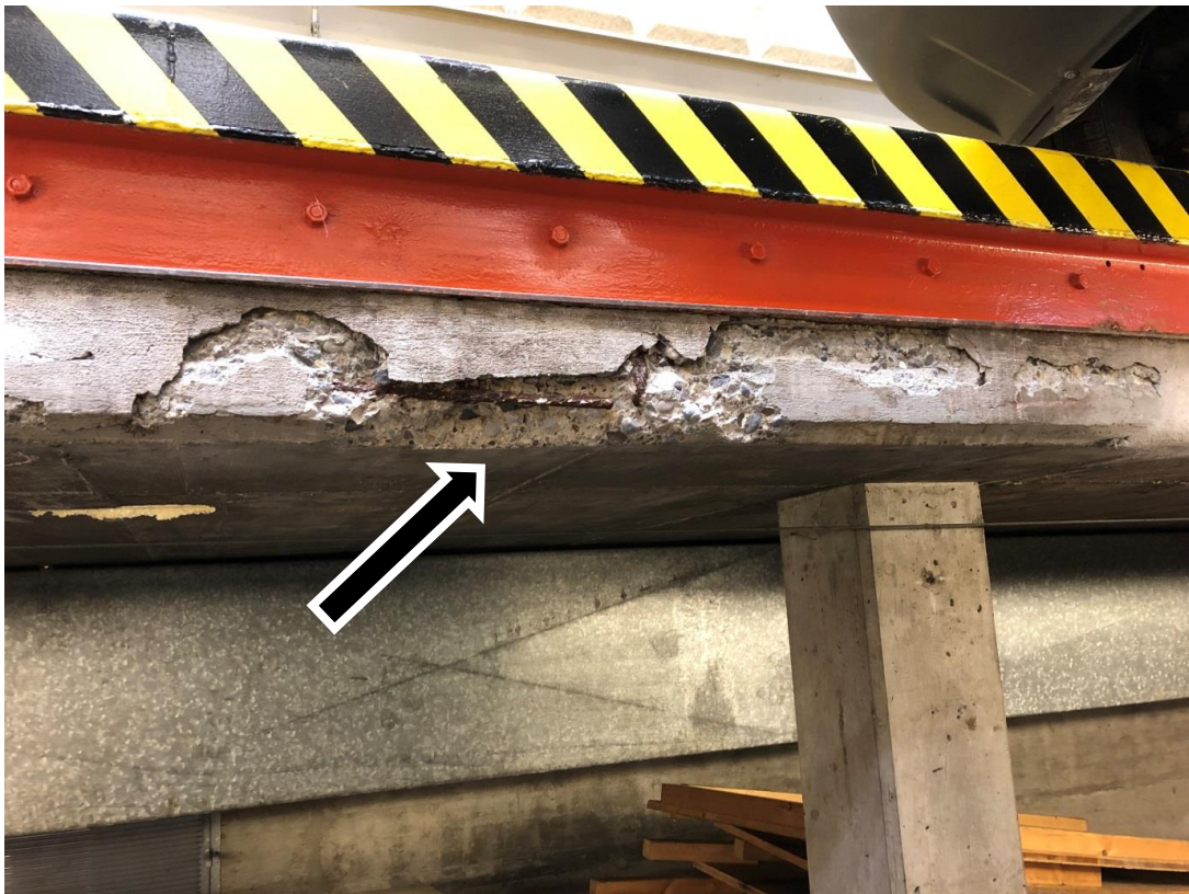
Foto 3 Abplatzungen an der bestehenden Betonstruktur, freigelegte Armierungseisen sichtbar
