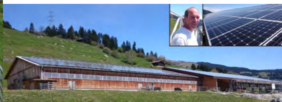
Abb. 4: 400 kW-starke PV-Anlage in Andiast/GR, 1'300 m ü.M. erzeugt ca. 400'000 kWh/a.
