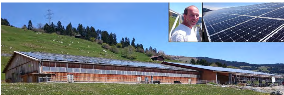
Abb. 11: 400 kW-starke PV-Anlage in Andiastr/GR, 1'300 m ü.M. erzeugt ca. 400'000 kWh/a.
